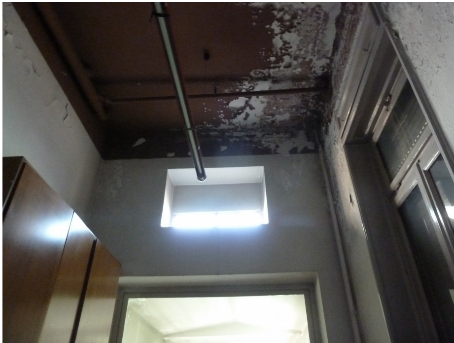
Fig. 7.7: Condizioni di degrado.
