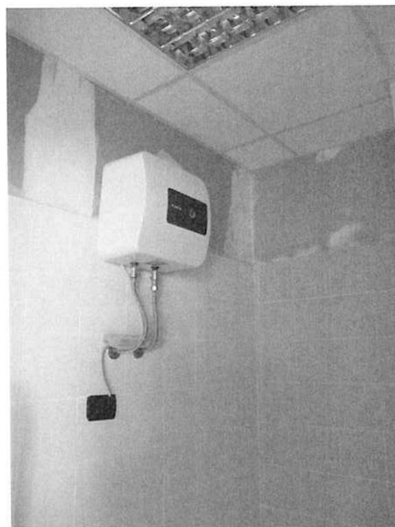
Servizi igienici – Bollitore elettrico per acqua calda
